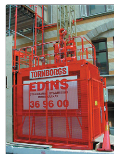
Bygghissar Kuggstång och hydrag
